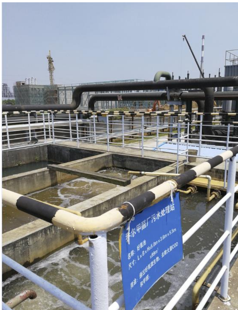
图 4-2 污水处理设施
