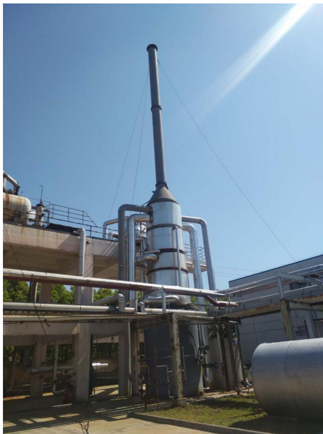
图 4-4 3#甲醛生产线废气焚烧炉及排气筒
